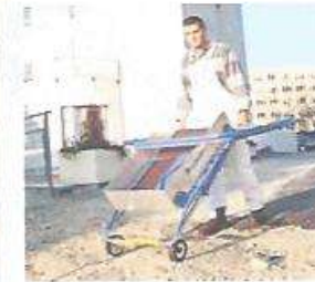
Figure 1. Plate-forme PIRL démontée
