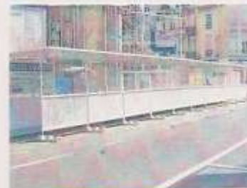
PASSAGE PIETONS PROTEGE
